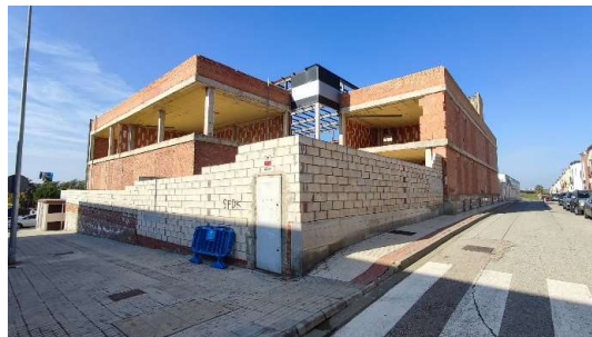
Imagen en la que se aprecia que el CT no está alineado con la línea de fachada de la edificación en construcción.
