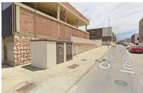
Imagen de la calle Centro Popular Instructivo con el centro de transformación y las arquetas en el acerado. Fuente: Google Maps
